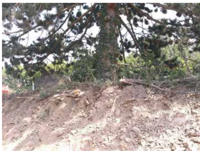
Altération occasionnée lors d'un chantier de voirie
