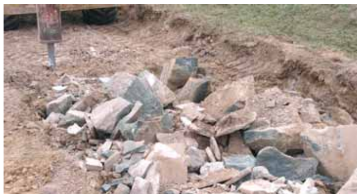
La dépollution des sols par retrait des débris de chaussée avant plantation s'avère indispensable pour réaliser des aménagements durables.
