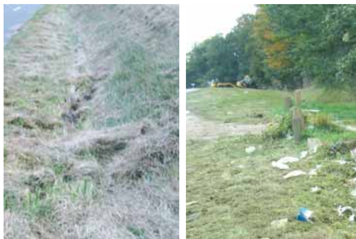
Les déchets issus de l'entretien des dépendances vertes sont d'origines et de natures très diverses : produits de fauchage, détritus divers.
