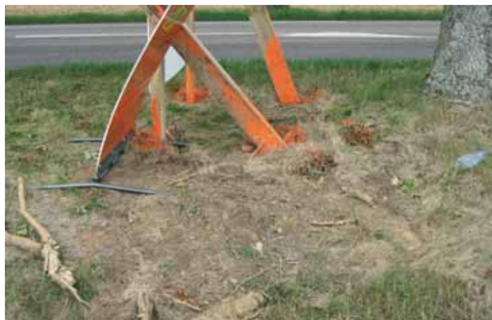
A éviter : réduire au maximum l'altération du système racinaire au cours des travaux de voirie
